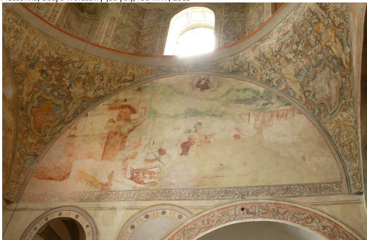
Pułtusk, kościół kolegiacki pw. Zwiastowania Najśw. Marii Panny, boczna kaplica-mauzoleum biskupa plockiego Jędrzeja Noskowskiego, ściana wschodnia, poważnie uszkodzona scena Nawrócenie św. Pawła apostoła w drodze do Damaszku , polichromia renesansowa, 1554-1560, technika mieszana, proj. Giovanni Battista Venetus z Płocka, wyk. Wojciech oraz Stanisław Pieczonka, obaj z Warszawy (atryb.), fot. MW, 2019
