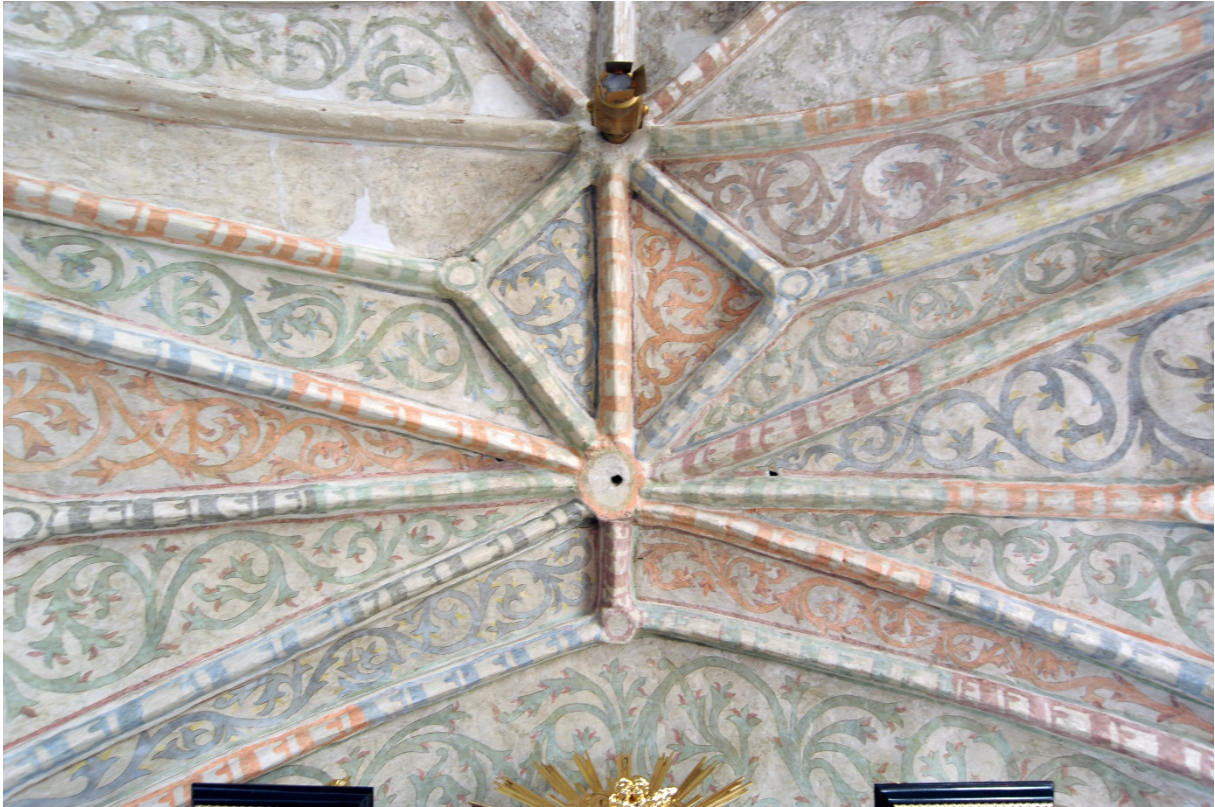
Czerwińsk nad Wisłą, klasztor kanoników regularnych (ob. salezjanów), skrzydło południowe, kapitułarz, sklepienie, przęśta I-III, późnogotycka polichromia pasowa tynkowanych żeber ceglanych oraz wysklepków z wicią akantową (niem. Astwerk), przed 1538, odkryte 1929, fresk, wyk. niezidentyfikowany malarz lokalny (?), fot. MW, 2016.
