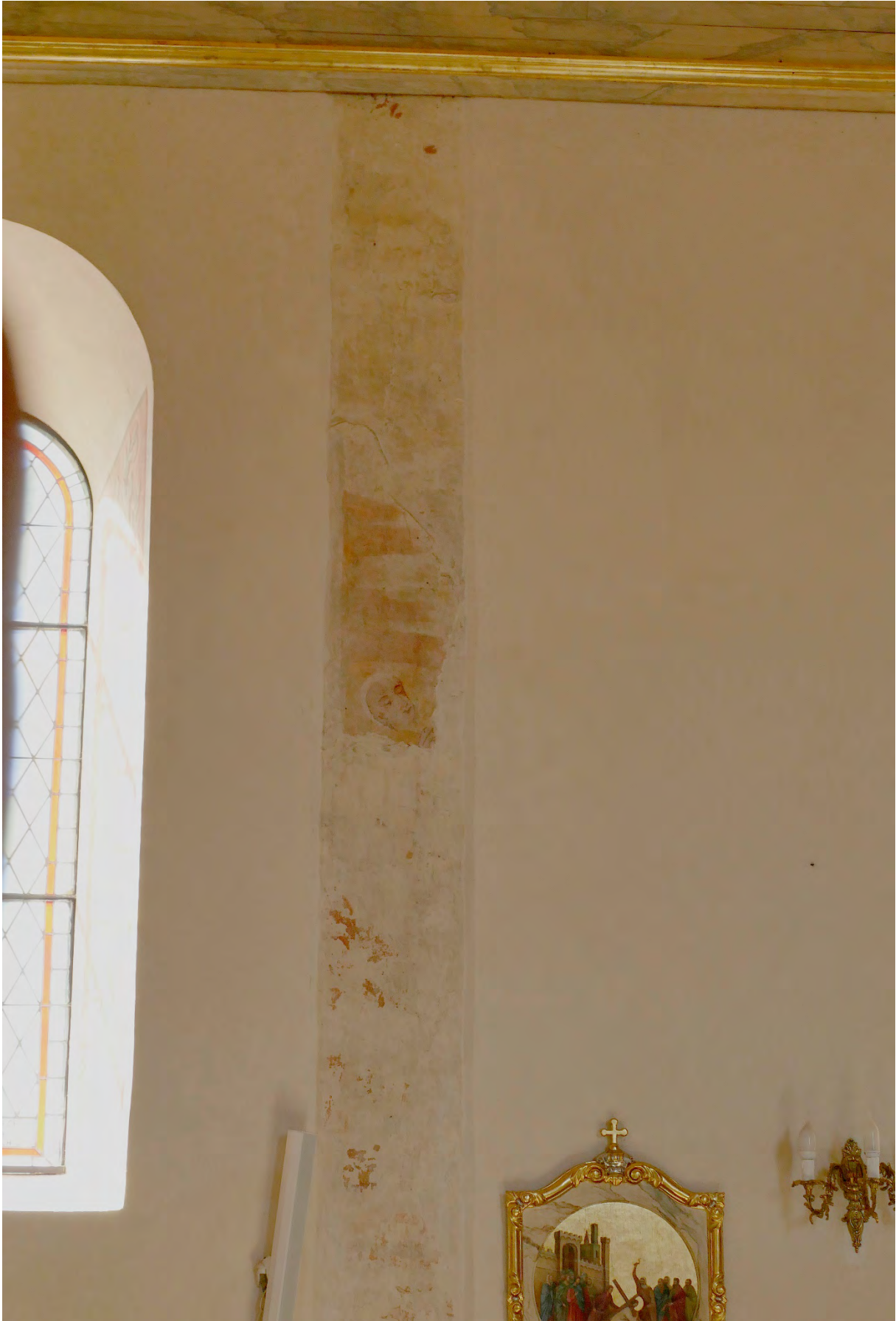
Niedźwiadna, kościół par. pw. św. Stanisława, ściana północna, fragment relikty dekoracji malarskiej, 1. poł. XVIII w., wyk. nieustalony warsztat malarski o pruskiej (?) proweniencji, fot. MW, 2019
