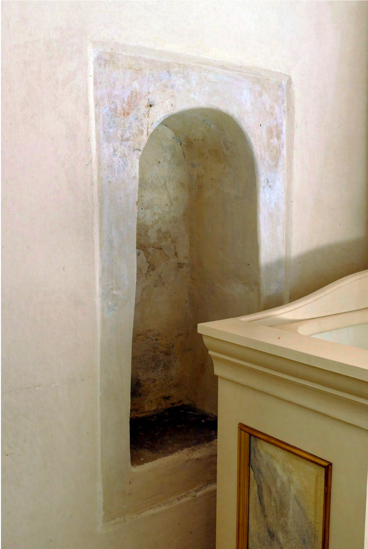
Niedźwiadna, kościół par. pw. św. Stanisława, ściana północna, fragment reliktu dekoracji malarskiej, 1. poł. XVIII w., wyk. nieustalony warsztat malarski o pruskiej (?) proweniencji, fot. MW, 2019
